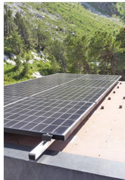
Nun haben wir Strom im Überfluss
